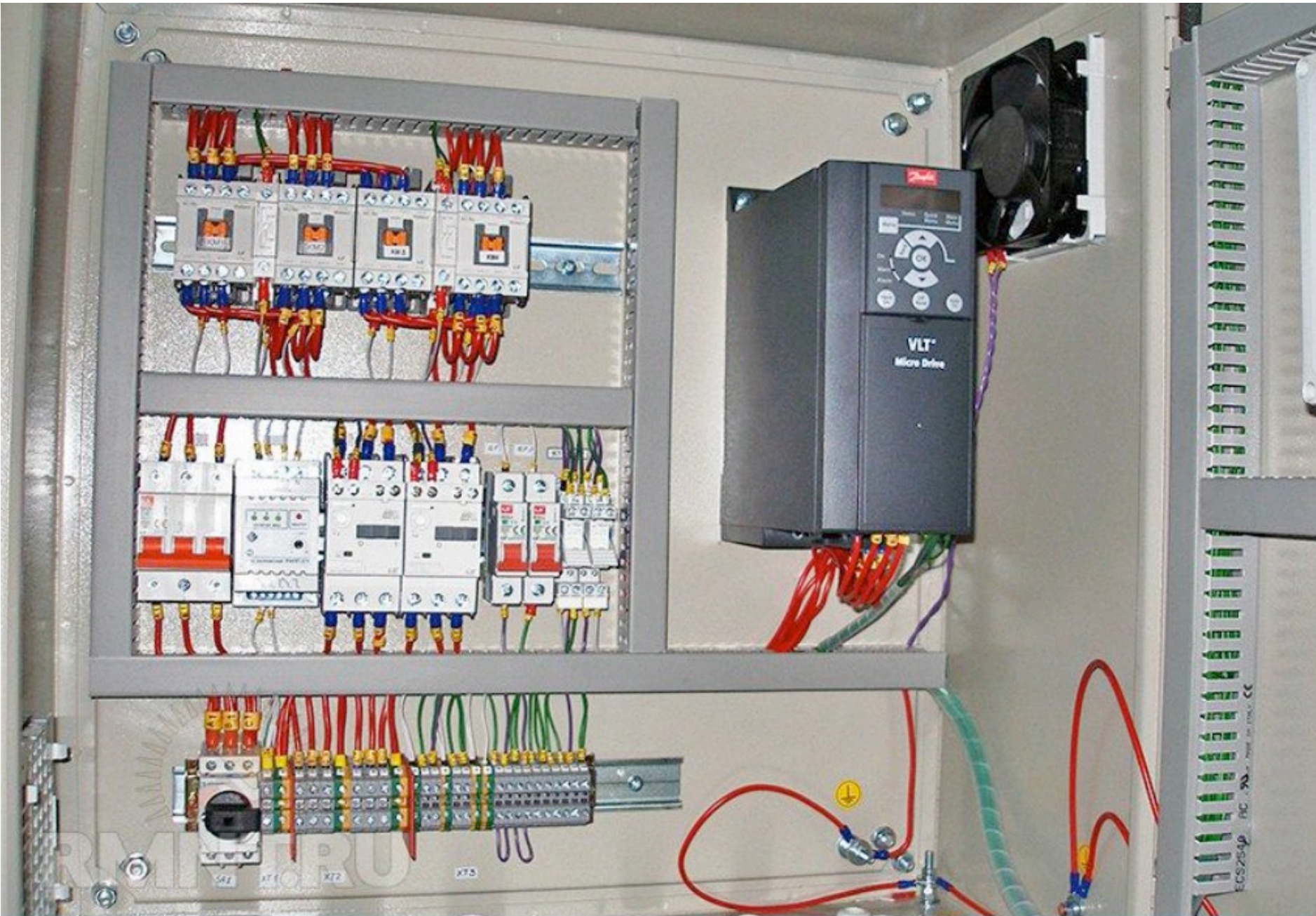
Зураг 13. Хөдөлгүүрийн тэжээлийн Инвертор бүхий щит
