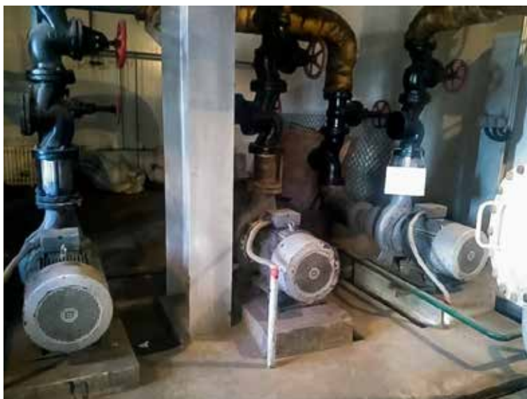
Зураг 64: Халаалтын зуухны эргэлтийн усны насосууд
