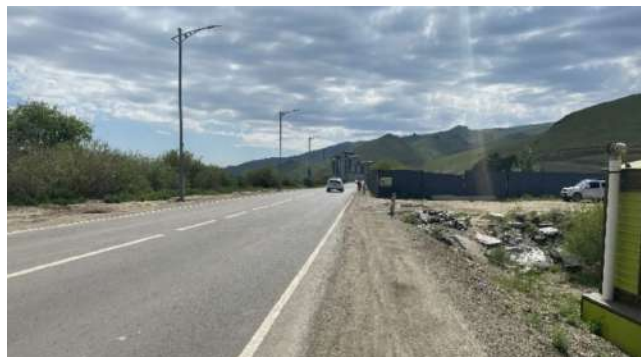
1. Дугуйн замын эхэнд болон замын гадаргуу дээр дугуйн зам эхэлж байгааг илтгэх тэмдэг, тэмдэглэгээ байхгүй.
