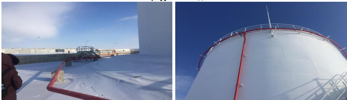
Зураг 20. Галын усан сан, Сав хөргөх, усан хөшиг үүсгэх тоног төхөөрөмжийг байрлуулсан байдал
