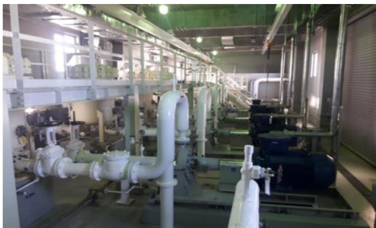
Зураг 1-15. Шатахууны агуулахын насосны станц
